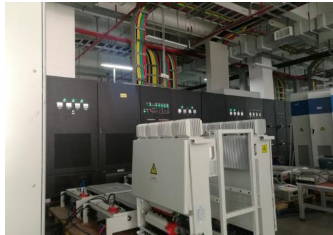
3 MW PV лаборатория (сол.панели)
