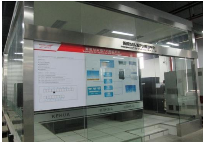
1 MW PV лаборатория
