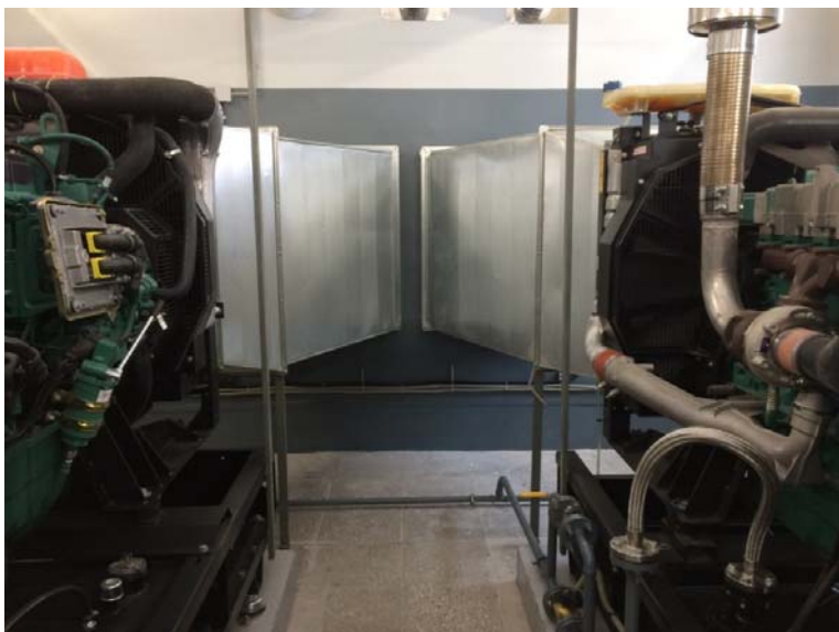
Две ДЭС по 275кВА (ВНИИФТРИ, Московская область)
