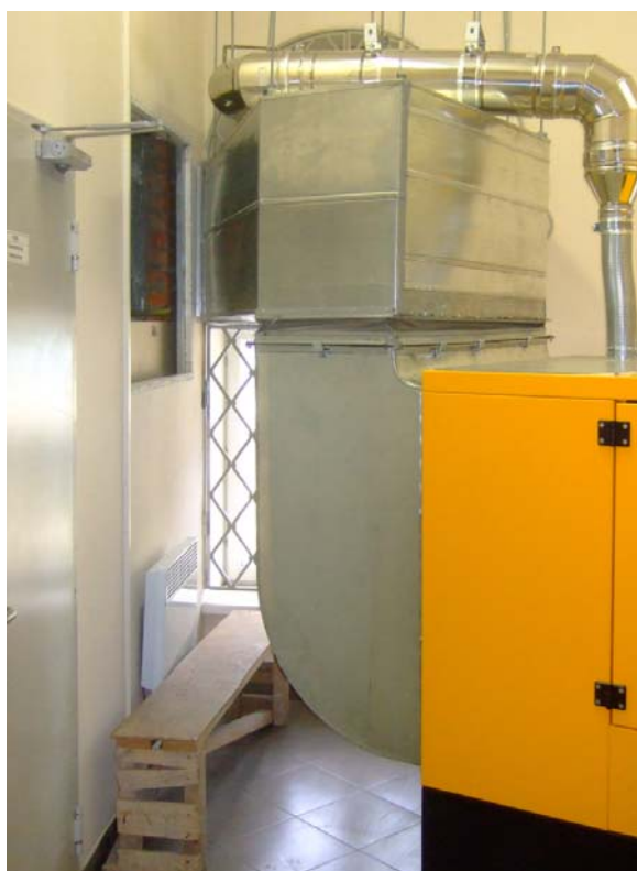
ДЭС 90кВА в шумозащитном кожухе (Райфайзен банк, Москва)
